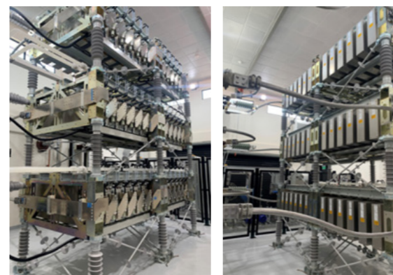
Sala de Convertidores STATCOM – SE Paraíso
