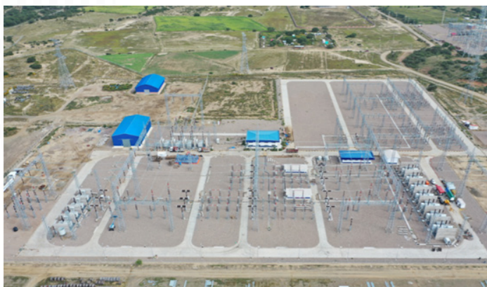
Subestación Santivañez 500 kV
